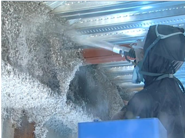
吹付けロックウール (NM-8601)
