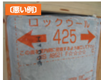
マットの隙間
