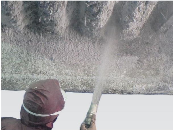
吹付けロックウール (NM-8601)
